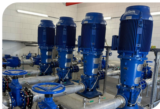
O sistema de pressurização de Loisberg alimenta o depósito de Mittelberg
