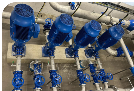
Sistema de pressurização no depósito com bombas MPV
