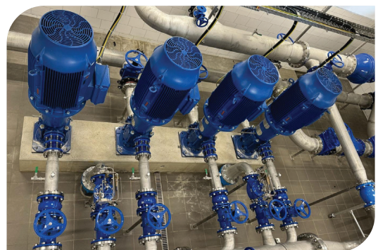
Drucksteigerungsanlage im Hochbehälter mit MPV-Pumpen
