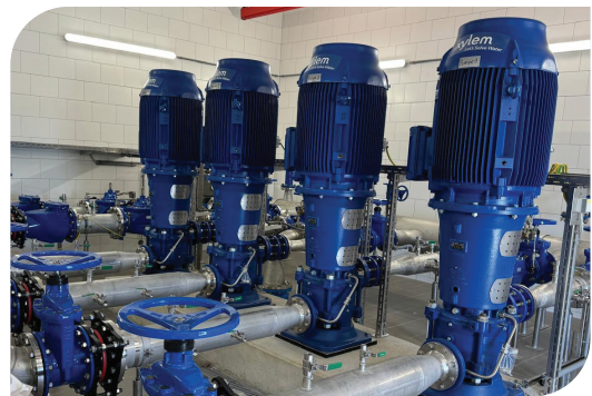
Drucksteigerung Loisberg fördert in den Hochbehälter Mittelberg
