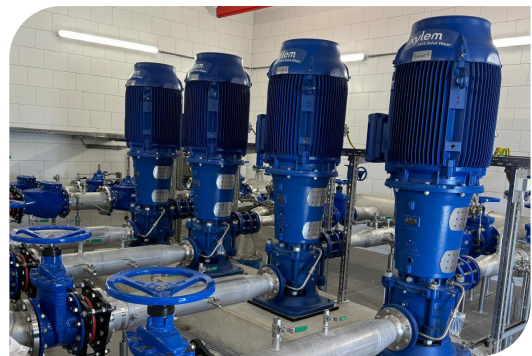
Il sistema di pressurizzazione di Loisberg alimenta il serbatoio di accumulo di Mittelberg
