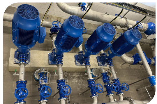
Sistema di pressurizzazione nel serbatoio di accumulo con pompe MPV
