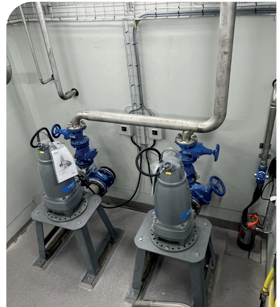
Torrt uppställda pumpar i den nya pumpstationen i Kristvallabrunn, utformade för stabil drift vid varierande flöden.
