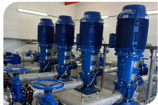
Le système de surpression de Loisberg alimente le réservoir de stockage de Mittelberg
