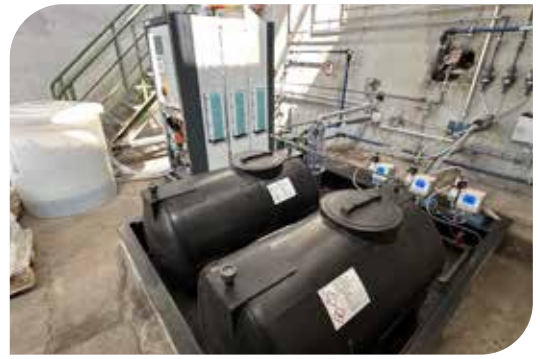
À l'arrière-plan, l'installation OSEC NXT avec le réservoir de dissolution du sel blanc à gauche
