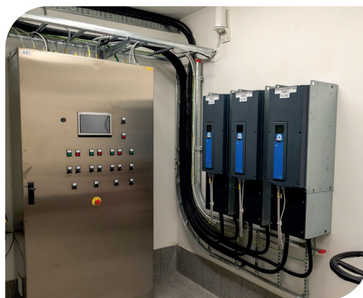
Styrskåpet i huvudpumpstationen samt frekvensomriktare.
