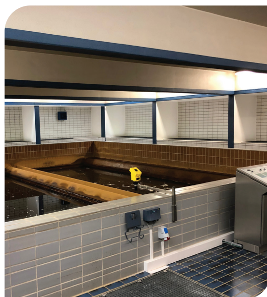
Fig. 1: Vue du système de filtration de gravier à l'usine d'eau d'Eutin
