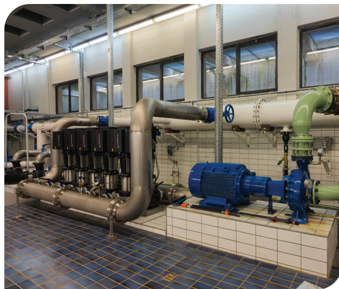
Fig. 3: Dans la station de pompage, l'eau potable traitée est pompée dans le réseau de distribution
