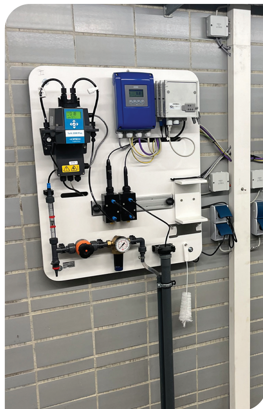
Fig. 2: Pannello dell'acqua potabile WTW all'uscita dei sistemi di filtrazione della ghiaia per monitorare torbidità, pH e ossigeno
