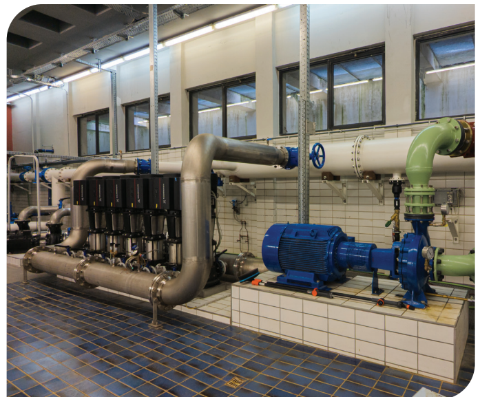
Fig. 3: Nella stazione di pompaggio, l'acqua potabile trattata viene pompata nella rete di distribuzione
