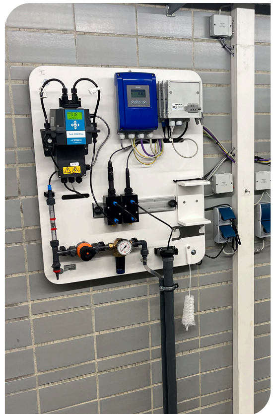
Abb. 2: WTW-Trinkwassertafel am Ausgang der Kiesfilteranlagen zur Überwachung von Trübung, pH und Sauerstoff
