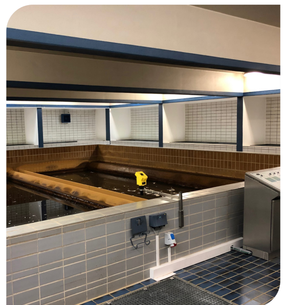
Abb. 1: Einblick auf die Kiesfilteranlage im Wasserwerk Eutin
