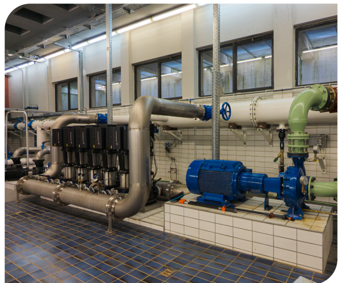
Abb. 3: In der Pumpenstation wird das aufbereitete Trinkwasser ins Verteilnetz gepumpt
