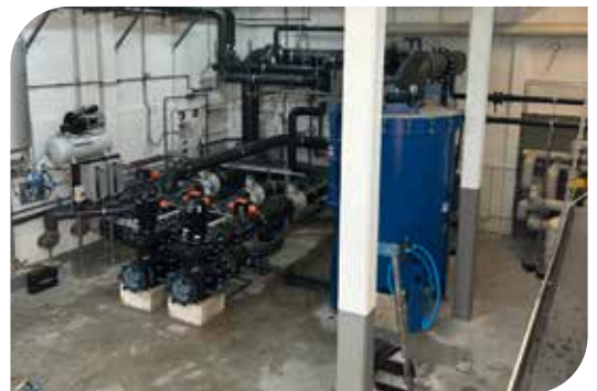
Platzersparnis Technikraum mit neuem Anschwemmfilter
