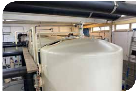
Alte abgängige Sandfilteranlage
