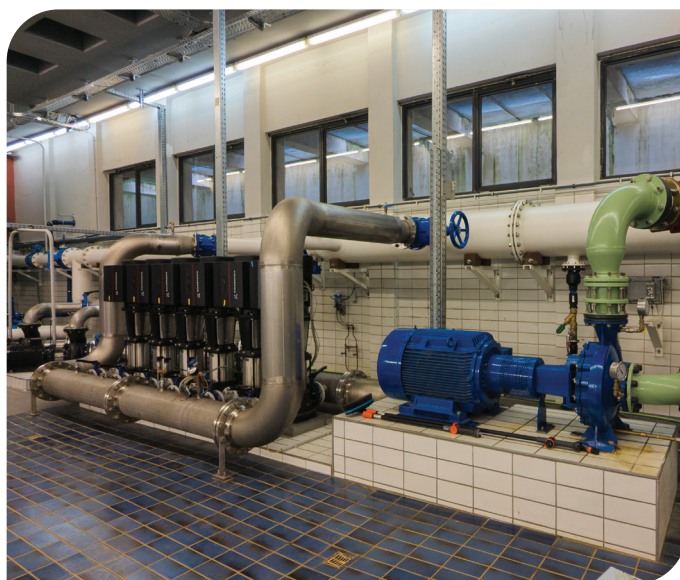
Fig. 3: En la estación de bombeo, el agua potable tratada se bombea a la red de distribución
