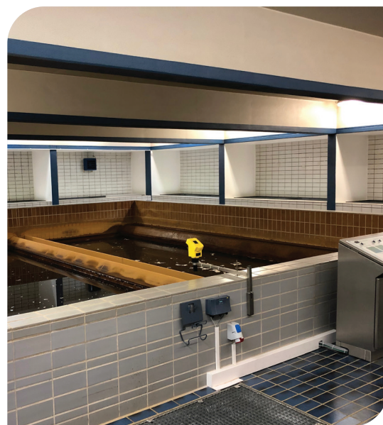
Fig. 1: Vista del sistema de filtración de grava en la planta de agua de Eutin
