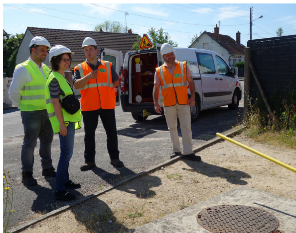
Intervenants de Suez et Xylem sur site à la station de Sully-sur-Loire
