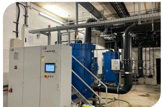
Technikraum mit neuen Anschwemmfiltern
