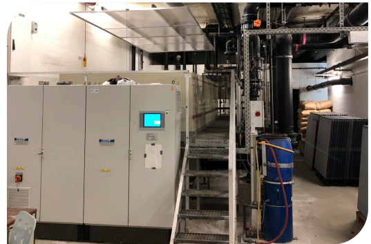
Alte offene Anschwemmfilter
