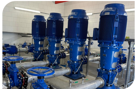
El sistema de bombeo de Loisberg alimenta el depósito elevado de Mittelberg
