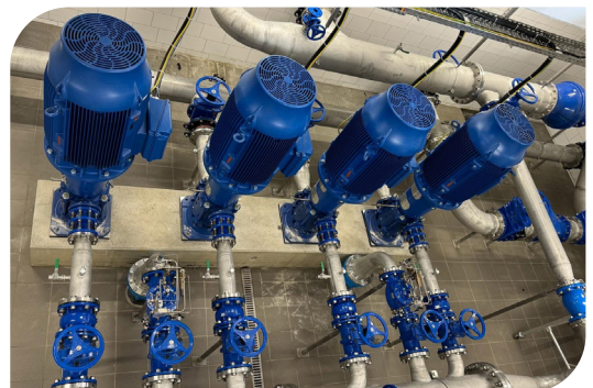
Sistema de presurización en el depósito elevado con bombas MPV
